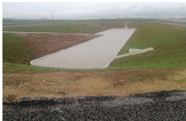
Exemple de bassin d'assainissement.
